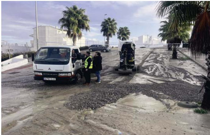
Imagen de los daños causados por la DANA.
